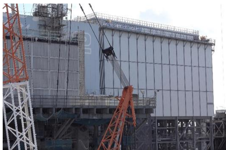
建屋(左)横に使用済み核燃料取り出し用の構台が建設された2号機=いずれも2025年1月、筆者撮影
